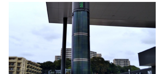
キャンピー柱に設置した 太陽電池
